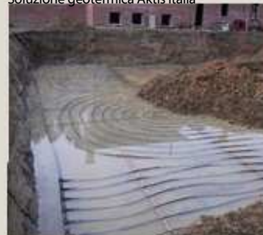
Soluzione geotermica Aktis Italia
